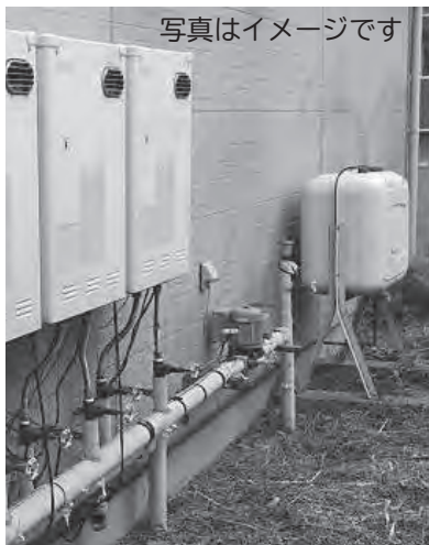
【入替給湯器(灯油式)】 使用燃料は精査中 (災害時対応も検討必要)
