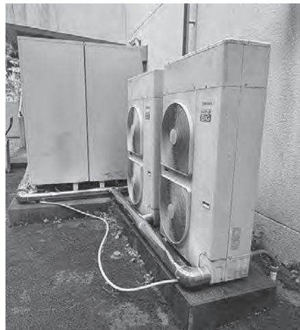
【現状の給湯器(電気式)】 ヒートポンプユニット(不具合あり) (給食対応のため早急に入替必要)
