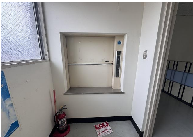
3階 食事運搬用リフト
