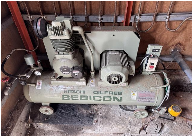
泉源ポンプ室
