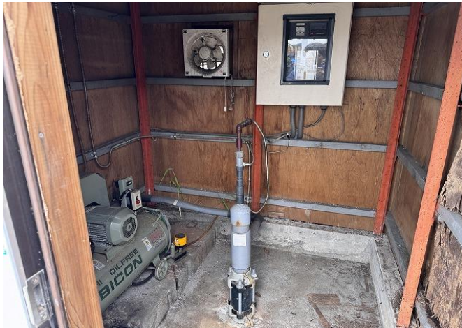
泉源ポンプ室
