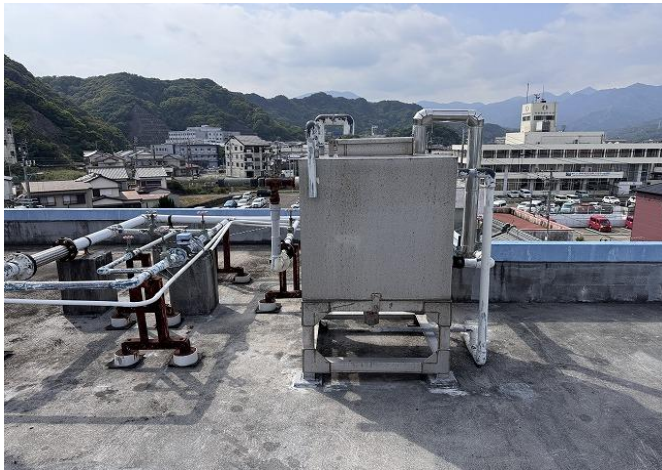
屋上（補給水タンク）
