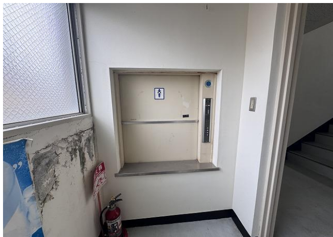
2階 食事運搬用リフト
